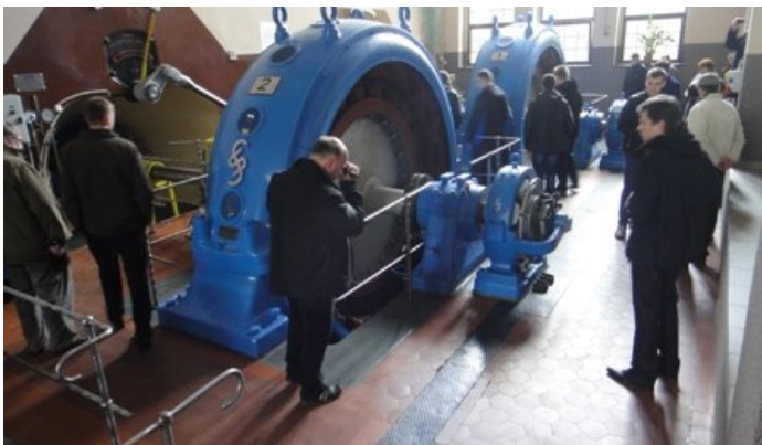
Fot. 3- w Elektrowni Gródek
