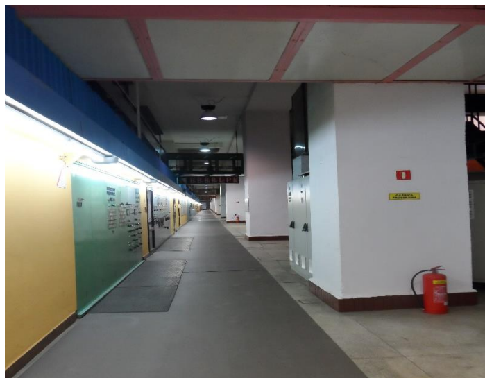
Fot. 2. Wnętrze elektrowni.
